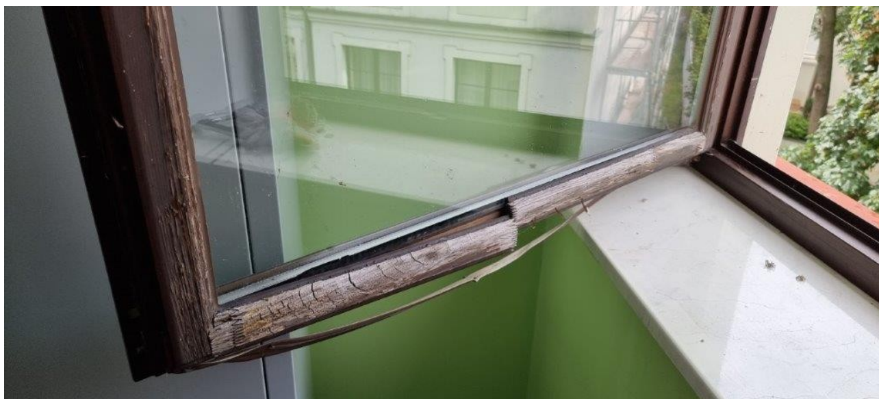
Przykład stanu technicznego istniejących okien drewnianych
