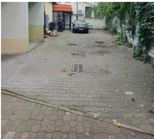
Widok stanu technicznego kostki na dziedzińcu
