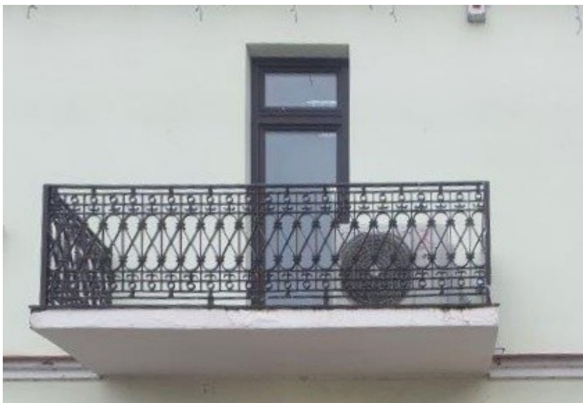
Widok stanu technicznego balkonu nad wejściem
